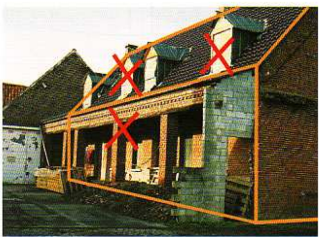
des travaux qui dénaturent le bâtiment
