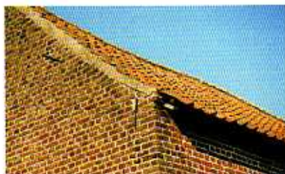
un débordement du toit sur le mur gouttereau traditionnel et lié à l'absence de gouttière
